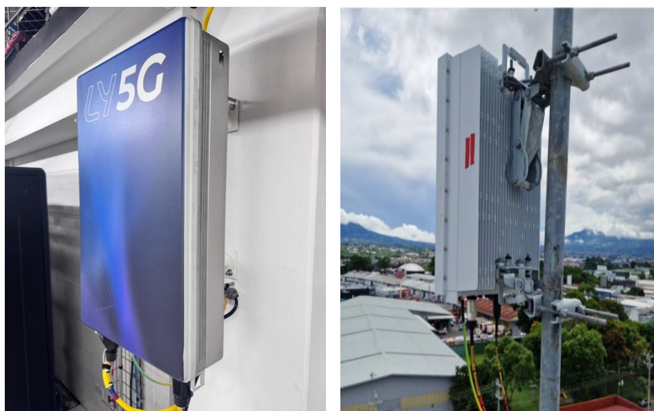
Figura 8. Antenas de redes móviles 5G desplegadas en el país. (Elaboración propia, fotografías cortesía de INFOCOM)
