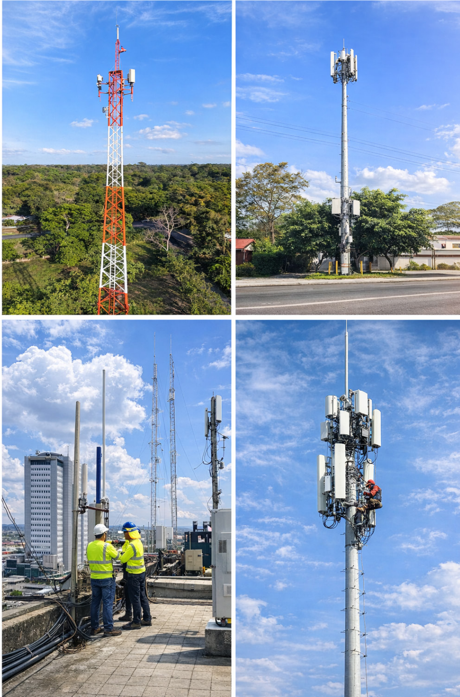
Figura 5. Celdas de cobertura de redes móviles desplegadas en el país. (Elaboración propia, fotografías cortesía de MICITT e INFOCOM)
