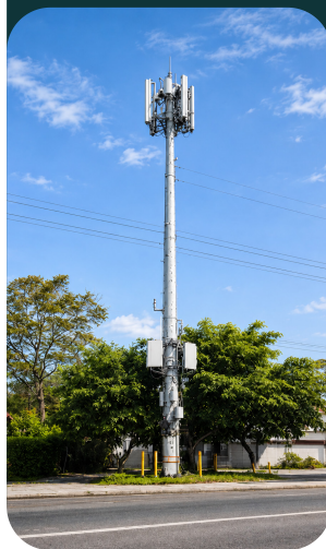
Poste de Telecomunicaciones
