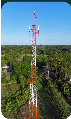
Torre de Telecomunicaciones
